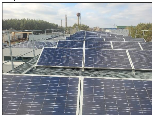
8 pav. Bendrovės saulės elektrinė
