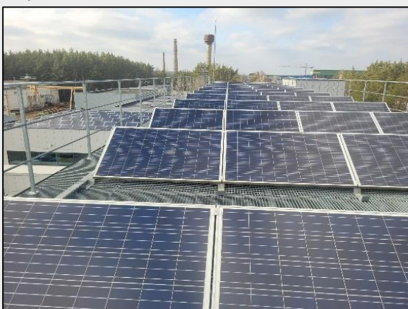
8 pav. Bendrovės saulės elektrinė
