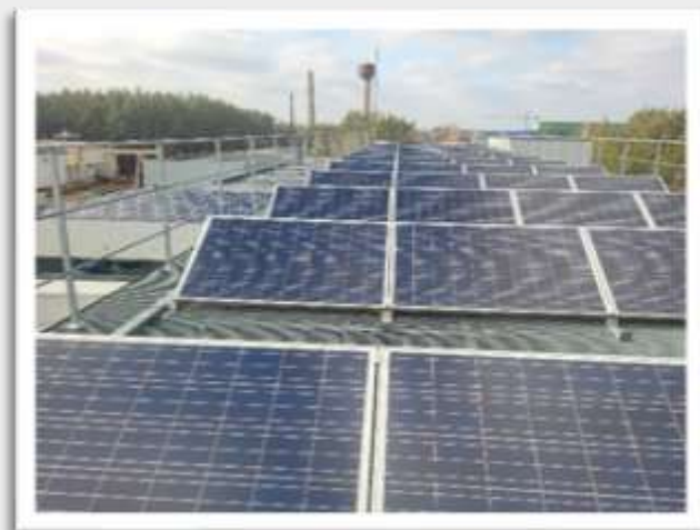
8 pav. AB „VIAMATIKA“ saulės elektrinė
